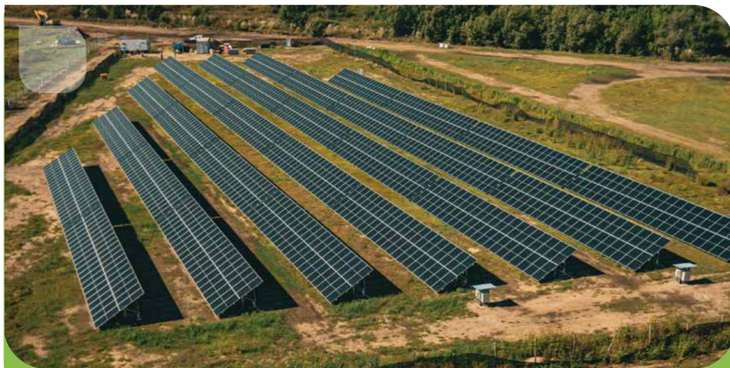
Parque Solar Fotovoltaico Arroyo Cabral
