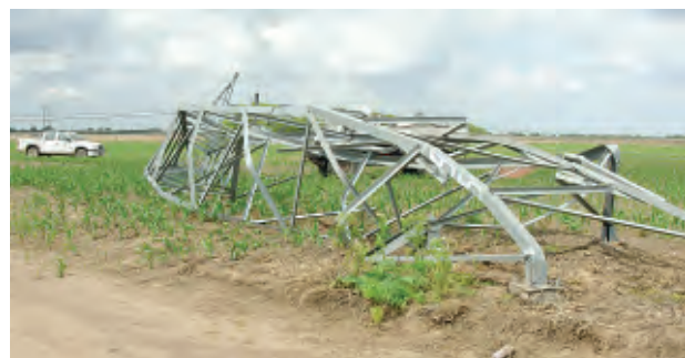
Las torres de 132 kV fueron retorcidas por los vientos huracanados que azotaron la zona.
