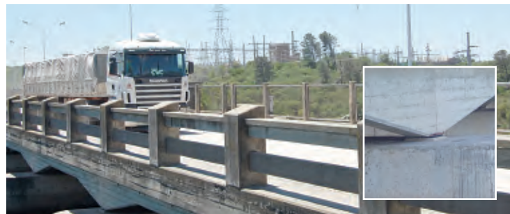
Tránsito continuo de camiones. En ciertos tramos, el dique sólo está apoyado sobre soportes de goma (detalle).
