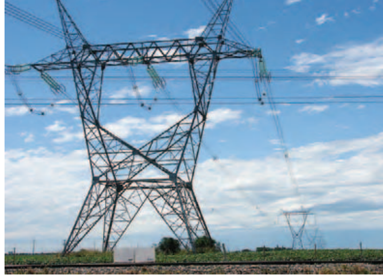
Torres de las líneas alta tensión de 500 kV que parten desde la Estación Transformadora Malvinas Argentinas.
